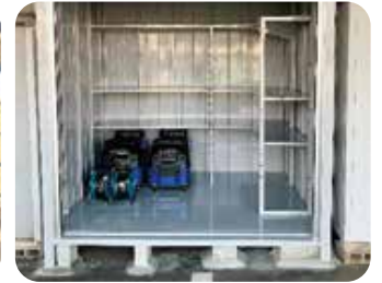
非常用発電機
