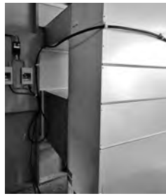
新しい乾燥設備
